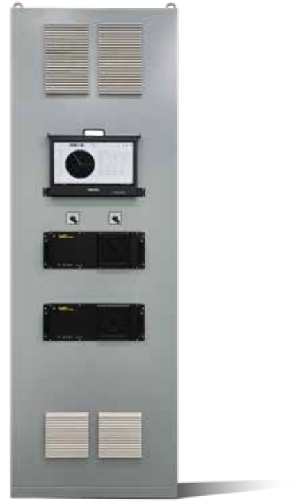
발전소 PA2000 실제 설치 사례
